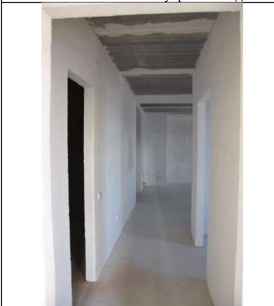
ФОТО № 23. Состояние внутренней отделки квартиры №6.
